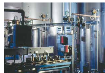
Prüfstand- und Innovationszentrum von Badger Meter
